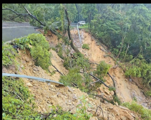
新娘潭路近涌背出現山泥傾瀉，亦有樹木橫互在馬路上。 Geo Channel 土力場fb圖片
